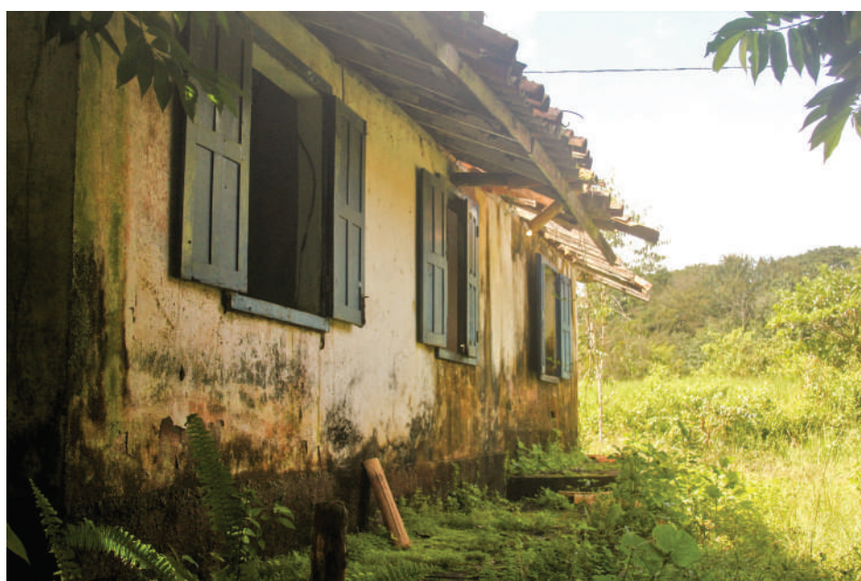
Foto 15: Estruturas deterioradas na Vila do Dique do período de funcionamento da empresa Pirelli. Fonte: Instituto Avaliação (2017).
